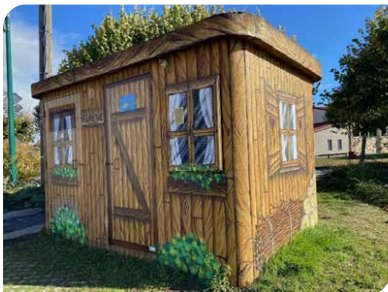
Transformateur du Plomb
